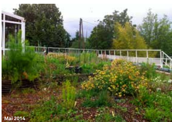
Toiture végétalisée expérimentale dans le Parc Georges Valbon, à la Courneuve, réalisée selon des principes écologiques par le département de Seine-Saint-Denis. © CD93, Laura Albaric
