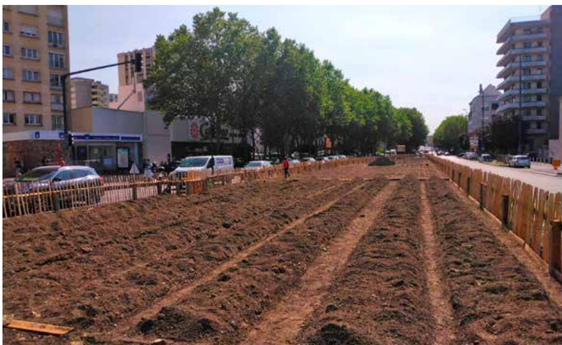
La renaturation du chemin de Halage (à Lil'ô) par la mise en place des substrats fertiles et de mélange terre pierre produit localement à partir de produits recyclés (terre inerte, compost de déchets verts, granulats de pierre). © Association Halage
