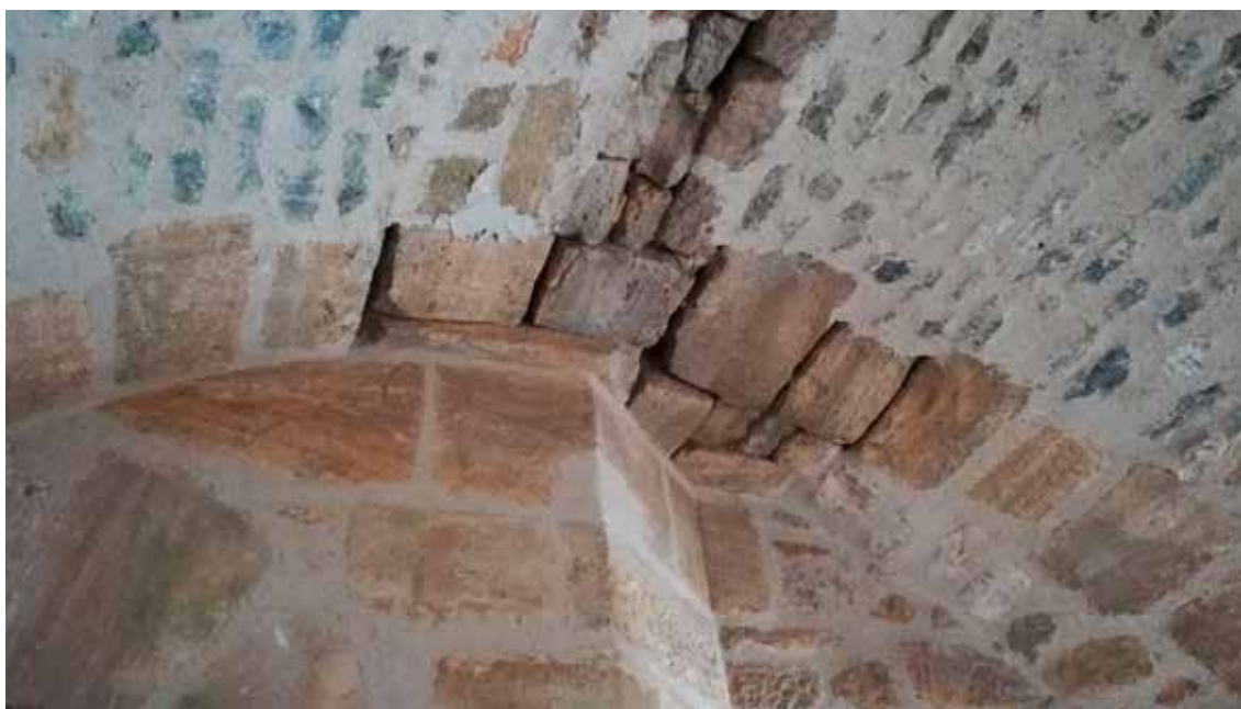
Galerie souterraine idéale pour les chauves-souris, grâce à ses fissures entre les moellons. © Émilie Périé
