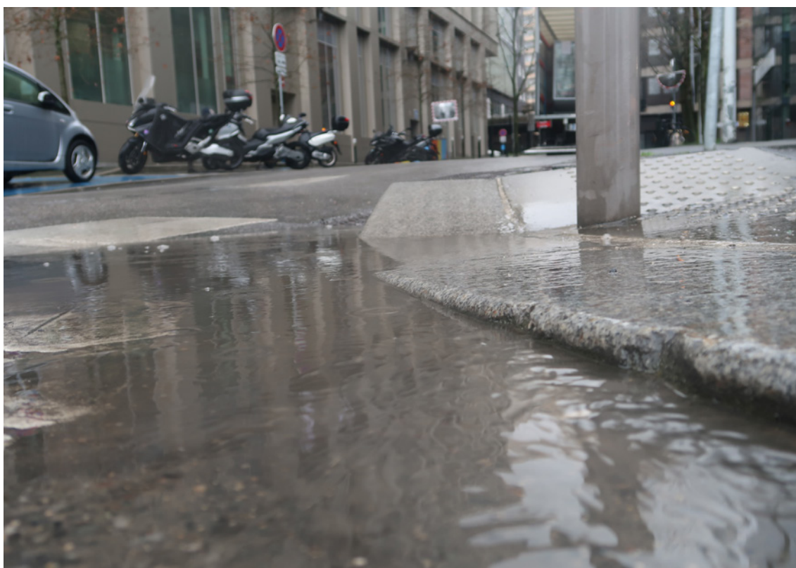
Le changement climatique va augmenter la fréquence et l'intensité des événements pluvieux extrêmes. Les problématiques de ruissellement urbain sont amenées à s'amplifier. © Nicolas Hannetel
