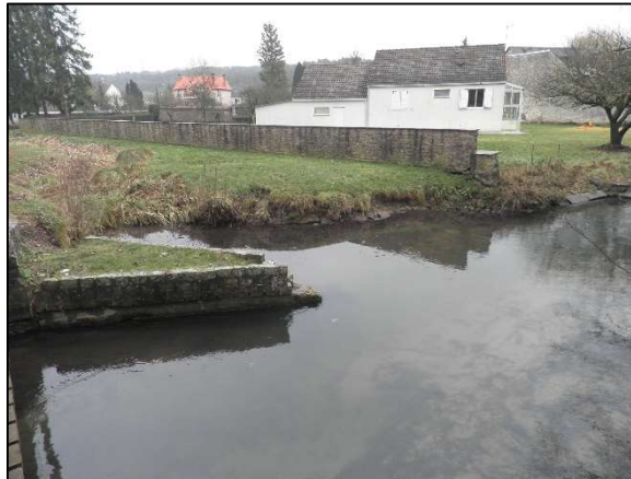
Erosion marquée en rive droite, berge dénudée
