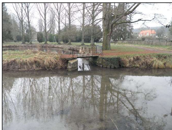
Berges effondrées de part et d'autre des passerelles
