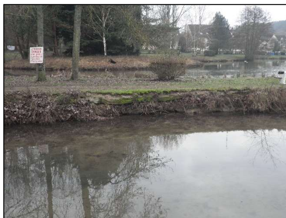
Affouillement de la berge sous le chemin piétonnier
