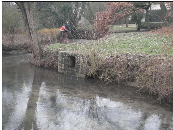
Erosion latérale en rive gauche, berge dénudée
