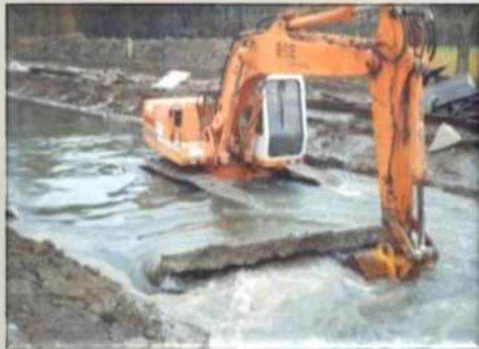
Retrait de béton du lit de l'Orge à Morsang sur Orge en 1997
