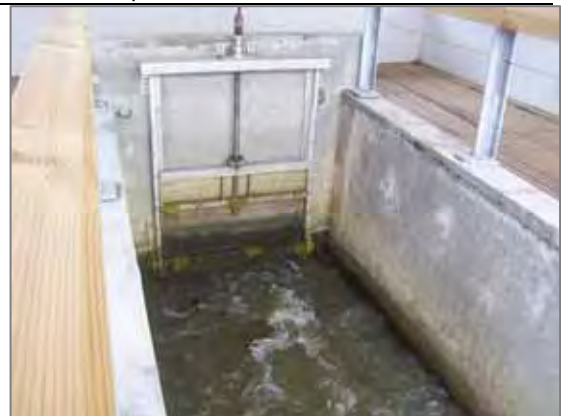
Vanne côté lac nord
