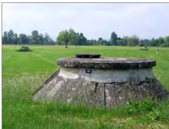
Captage d'eau potable (CEPA-J.Saillard)
