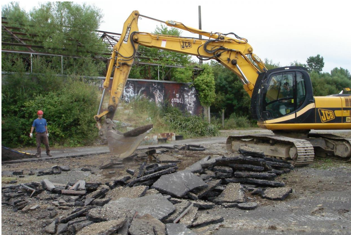
Desealing in progress in Saint-Nicolas du Redon carried out by the association “Les amis du transformateur”. © Les amis du transformateur
